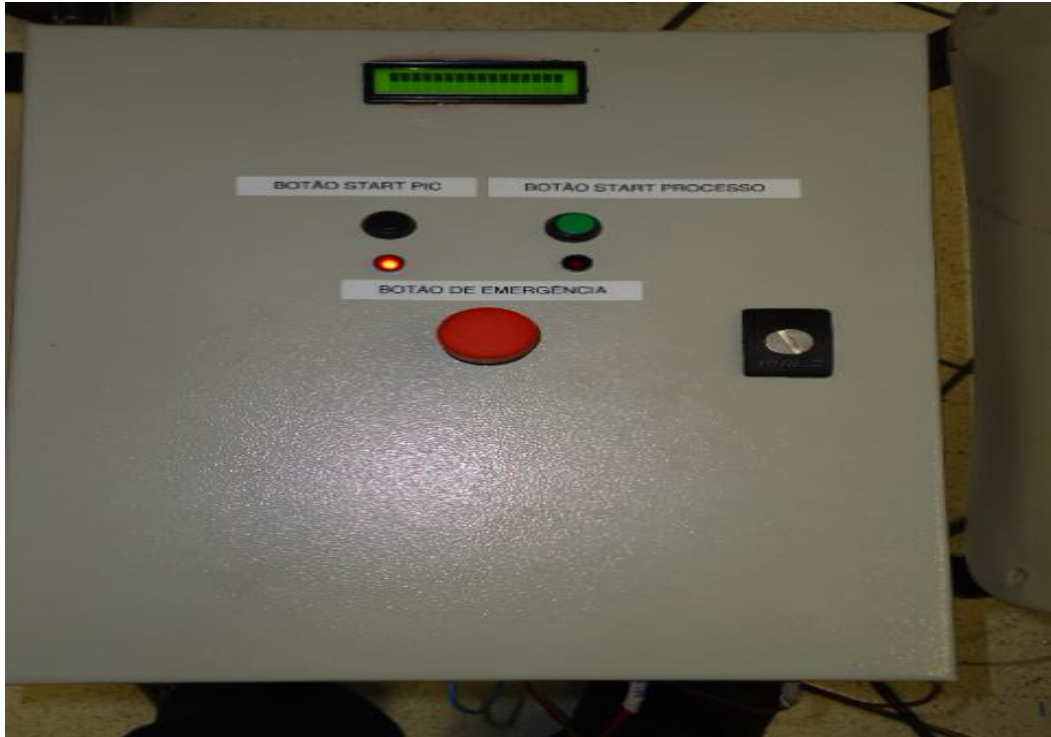
Figura 56 - Painel fechado, vista externa.
