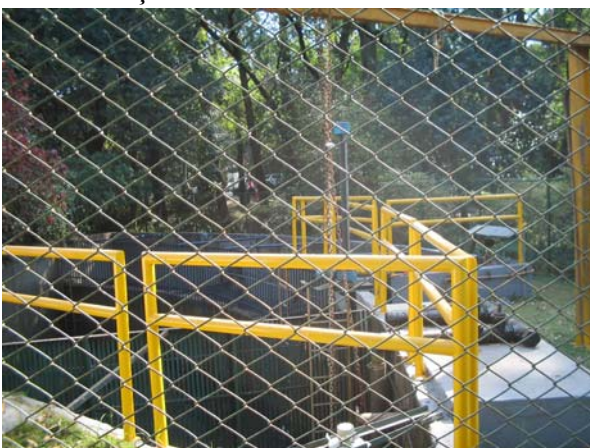
Foto 53 (julho/2010): Estação de tratamento de esgoto (ETE)
